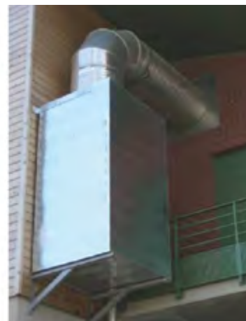
SILENCIEUX SUR RÉSEAU DE VENTILATION DÉSODORISATION
